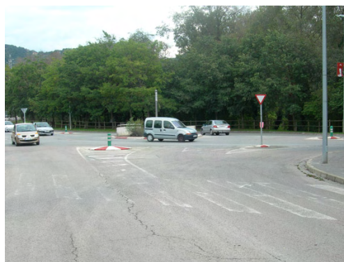
Senyalització horitzontal en estat deficient
