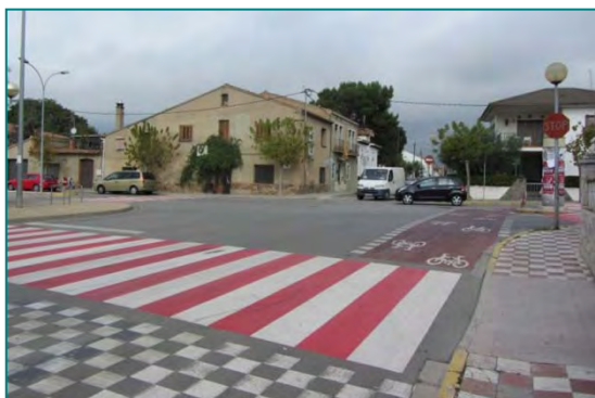
Imatge 30. Manca de senyalització horitzontal d'estop per a vehicles. Senyal vertical d'estop antiga i en mal estat.
