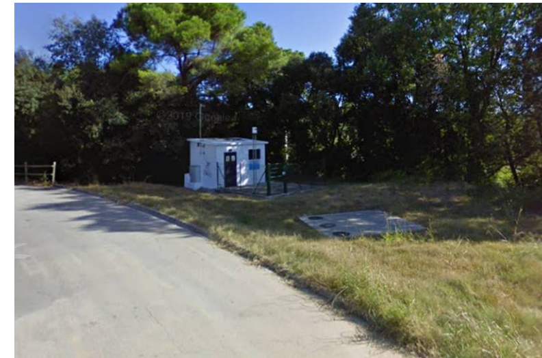
Estació de bombeig
